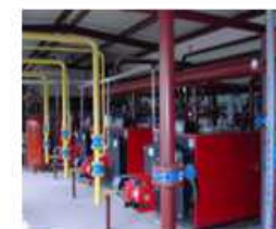
Подольский хлебокомбинат. Водогрейные котлы ICI RED 500
